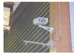
防犯カメラの設置
