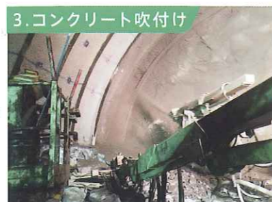
ブレーカにより落ちそうな岩を落とし、鋼製支保工を設置した後に岩盤表面に吹付機によりコンクリートを吹付け、岩盤が崩落しないように補強します。
